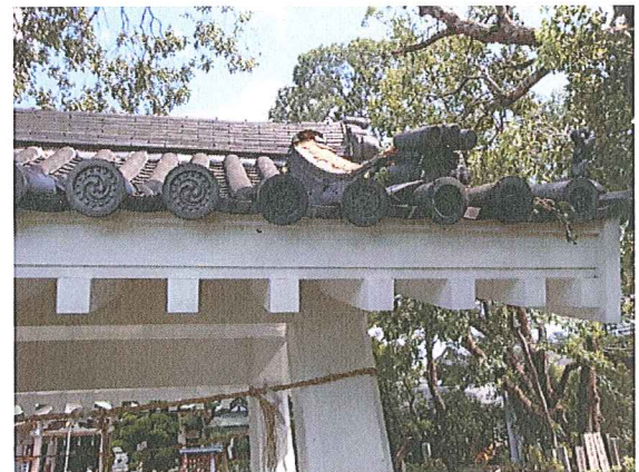
手水舎 屋根瓦破損
