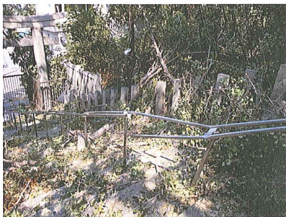
参道階段手摺破損
