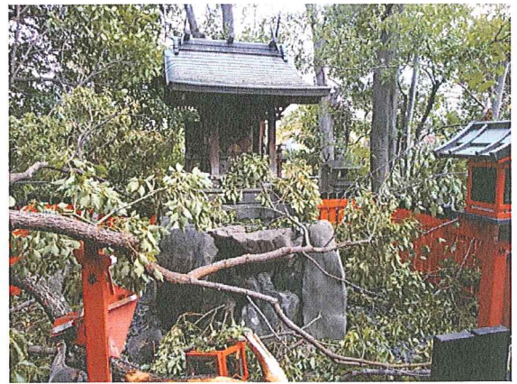
日吉稲荷本殿屋根一部破損 燈籠
