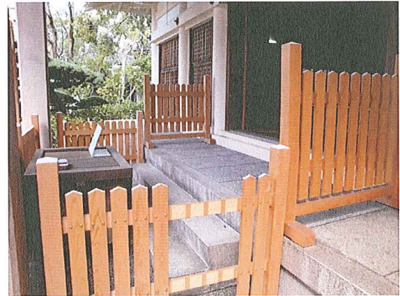
拝殿 結界破損
