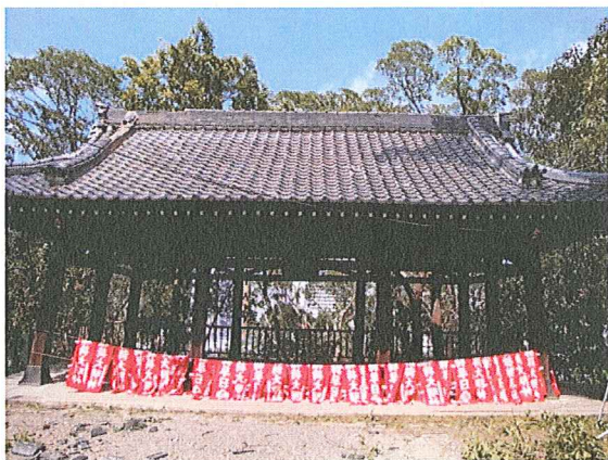
絵馬堂 屋根瓦破損
